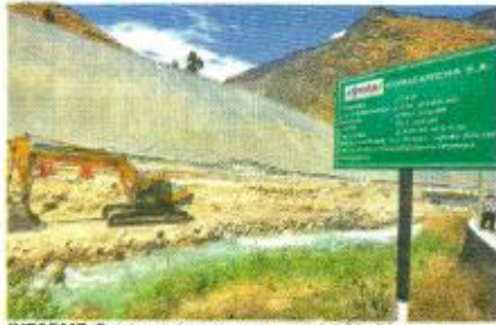
INFORME. Existen relaves muy cerca del Río Rimac.
